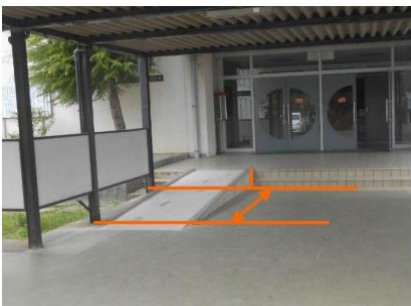
改修前の勾配がきついスロープ (登り口の位置が中央の柱)
