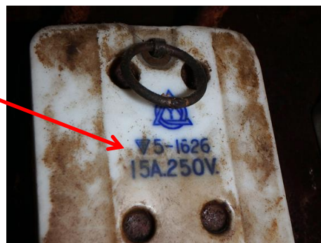
写真6 (分電盤の近景)
