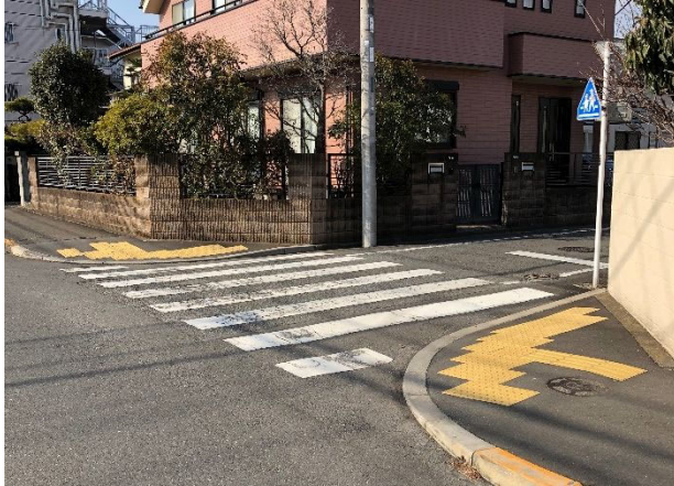
歩道2.3mで、接続する区画道路の部分で歩道のすり付け勾配がきつくなっている
