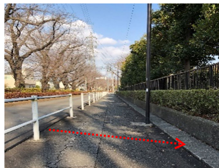
グラウンド側に横断勾配が付いているため、車いす使用者が通行しにくくなっています
