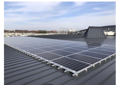
▲屋上（太陽光パネル）
