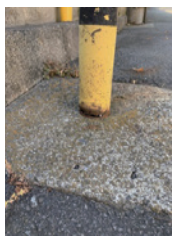
支柱根元の腐食
