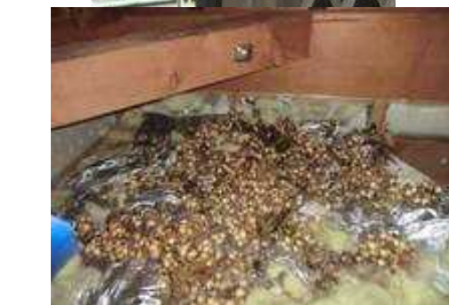
ハクビシンによる天井裏のフン害※1
