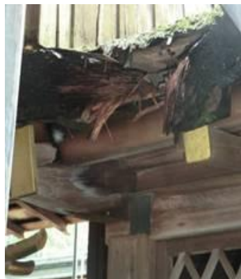
アライグマによる建物損害の被害※1
