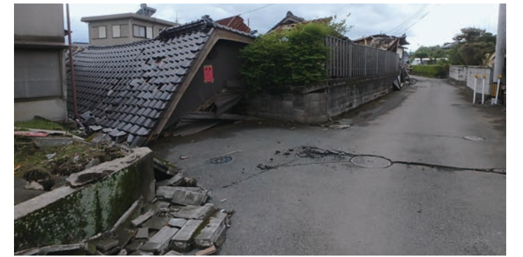
▲熊本地震の際、倒壊家屋に赤色のステッカーが貼られ危険を周知
