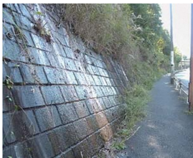
擁壁から染み出す湧水
