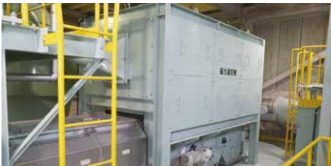
⑪ 磁力選別機 電磁石を使って破碎物の中から鉄類を取り出すものです。
