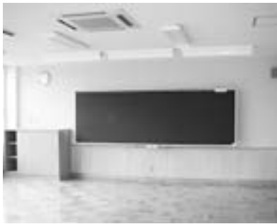
▲冷暖房機を設置した教室
