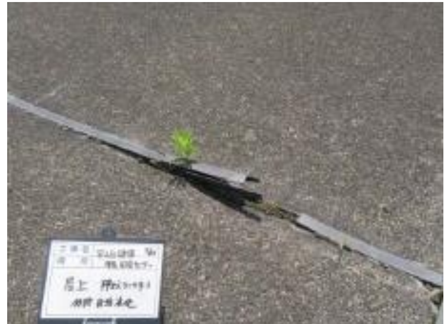
屋上防水機能の低下
