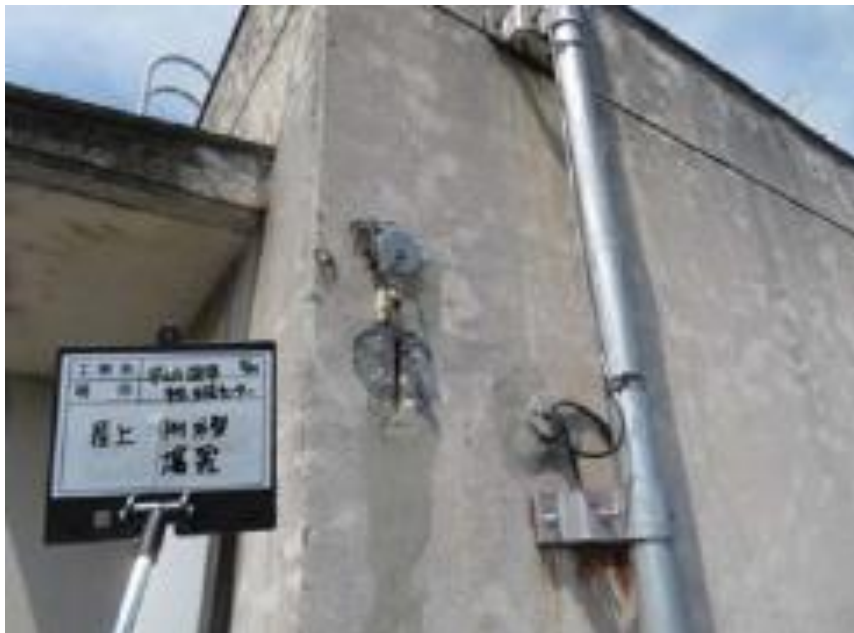
外壁劣化(鉄筋が露出)
