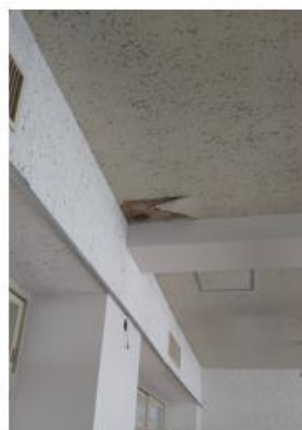
▲新校舎天井雨漏
