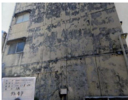
▲新校舎外壁剥離
