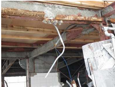
建物に残存した吹付け材
