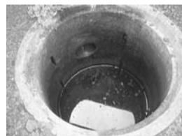
点検をしないと目詰まりの原因に
