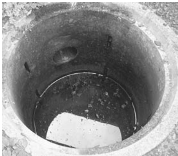
▲点検をしないと目詰まりの原因に
