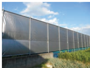
▲飛散を防止するシャッター
